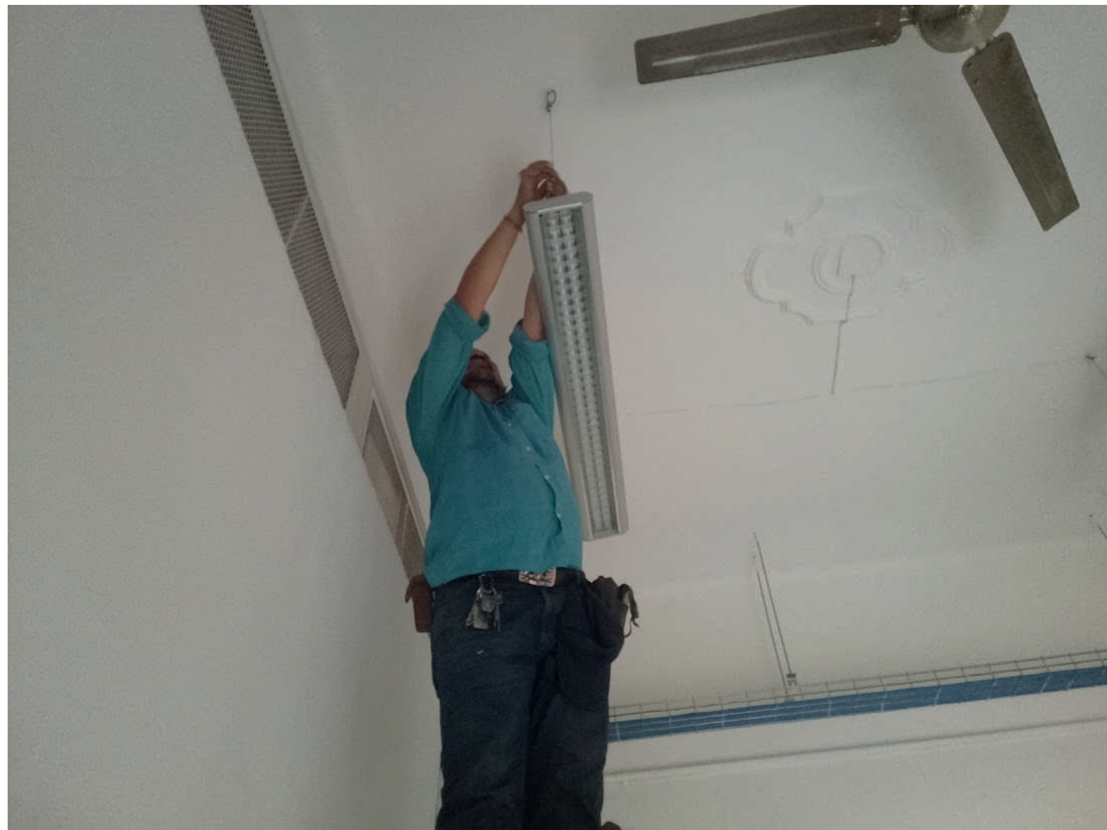
01. Cambio de luminarias cubiculo
